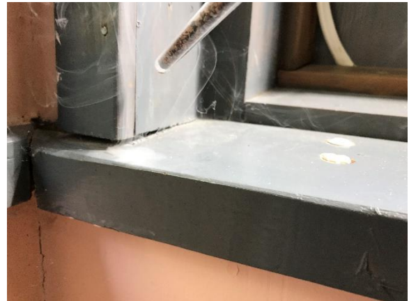
Kuva 19. Heikkoa ilmavirtausta itäsiiven ikkunaliittymästä sisäilmaan päin
