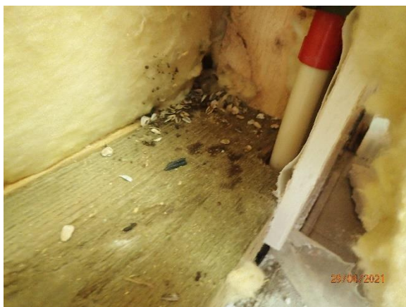
Kuva 44. Jyrsijöiden jättämiä jälkiä ulkoseinän eristekerroksessa
