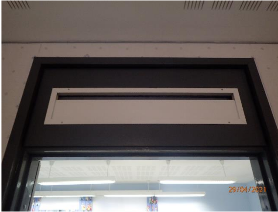
Kuva 46. Siirtoilmaventtiili luokan ja käytävän väliseinässä
