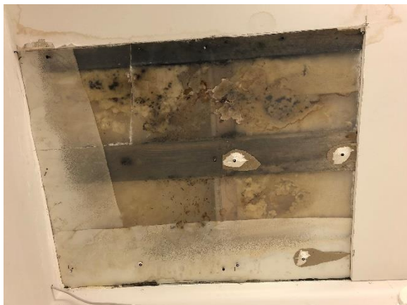
Kuva 30. Rakenneavaus 1, näkyviä kosteus- ja mikrobivaurioita yläpohjarakenteissa
