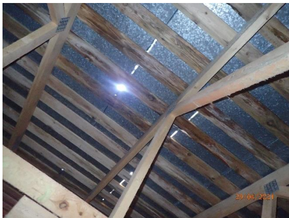
Kuva 36. Vesikaton saumojen epätiivelyskohdat
