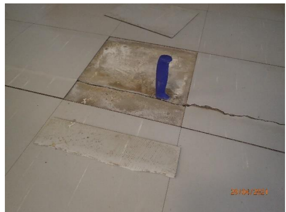
Kuva 7. Laajenusosan liittymän halkeama on syvä
