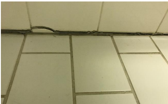
Kuva 24. Saumauksen ja laatan halkeilua seinän ja lattian välisessä liittymässä wc:ssä
