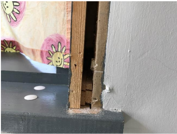
Kuva 22. Kanslian epätiivis ikkunaliittymä
