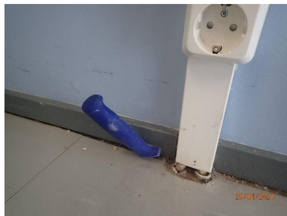
Kuva 11. Epätiivis liittyjä laajennusosan suuressa luokassa
