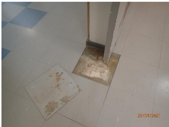
Kuva 8. Alapohjan kostea kohta, jossa pinnoitteen liima on vaurioitunut kosteuden vaikutuksesta
