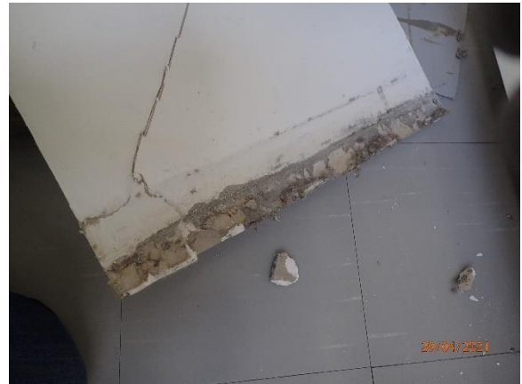
Kuva 17. Kanslian kohdalla lattian betonilaatta on valettu kipsilevyä vasten
