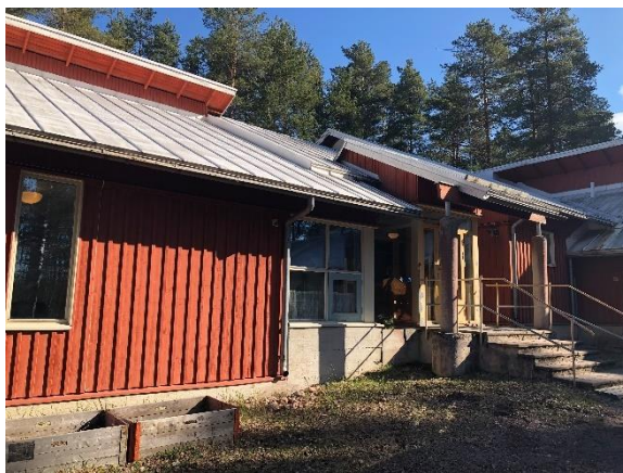
Kuva 34. Vesikaton moninaiset muodot, liittymät ja jiirit ovat riskirakenteita
