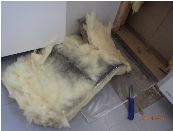
Kuva 16. Rakenneavaus 6, kanslia, ilmavuotojen aiheuttamia tummentumia seinäeristeessä
