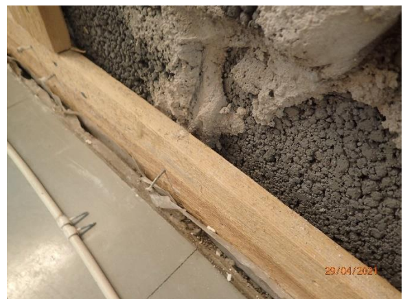
Kuva 13. Maanvastaisen seinän ja alapohjan liittymässä on rako
