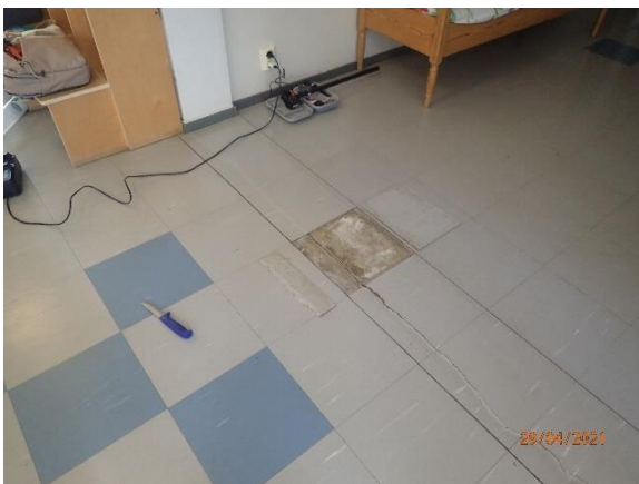
Kuva 6. Halkeamia alapohjassa vanhan ja laajennusosan liittymässä
