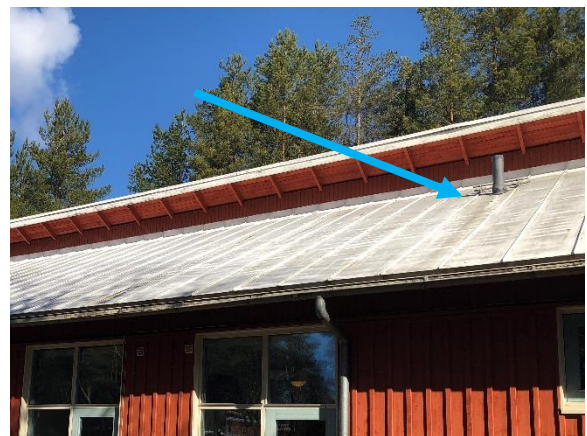
Kuva 35. Vesikaton läpivienti, jonka alapuolella alakattossa havaittiin kosteusjälkiä
