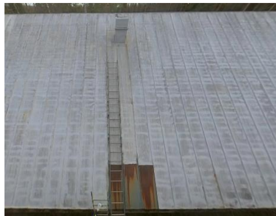
Kuva 37. Vesikatto vuotaa lapetikkaiden kohdilla
