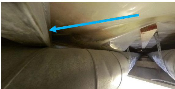
Kuva 28. Epätiivis höyrinsulkumuovi käytävän alakattotilassa, yläpohja eristeet pudonneet höyrinsulkumuovien päälle
