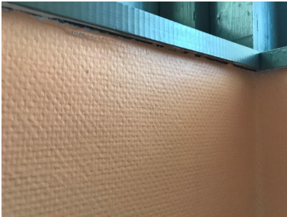
Kuva 18. Ikkunan epätiivis liittymä, kohdasta heikkoa ilmavirtausta sisäilmaan päin
