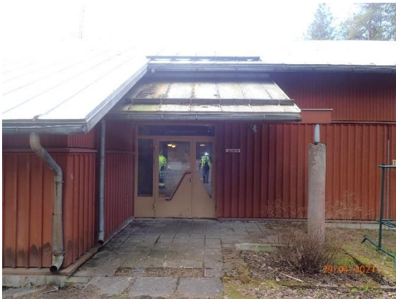
Kuva 4. Rakennuksen sokkeli on paikoin hyvin matala
