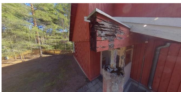
Kuva 40. Laho liimapuupalkin pää katoksessa
