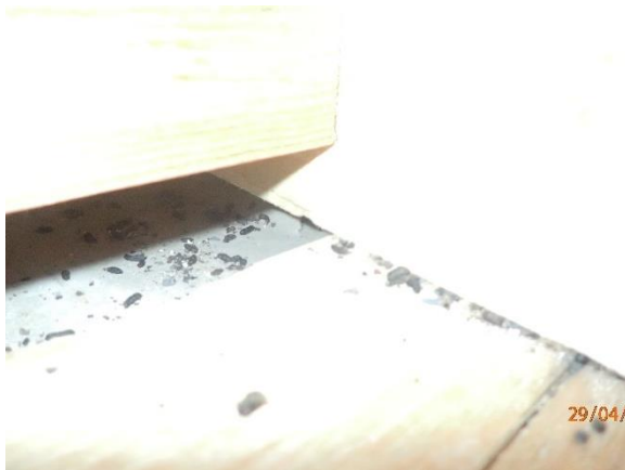
Kuva 42. Runsaasti jyrsijöiden ulosteita alakattolevyn päällä
