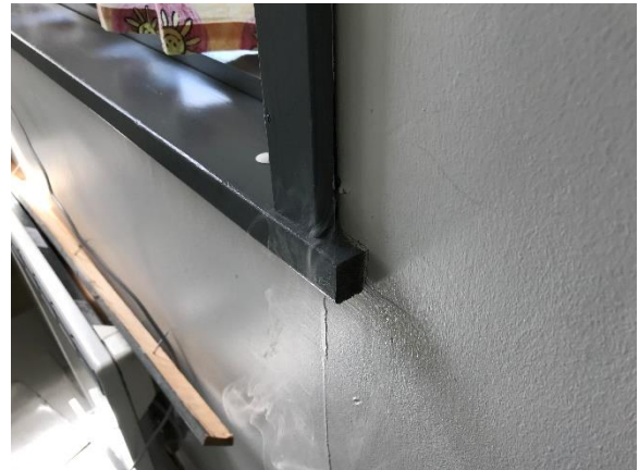
Kuva 21. Epätiivis ikkunaliittymä kansliassa, kohdassa heikkoa ilmavirtausta rakenteesta sisäilmaan päin
