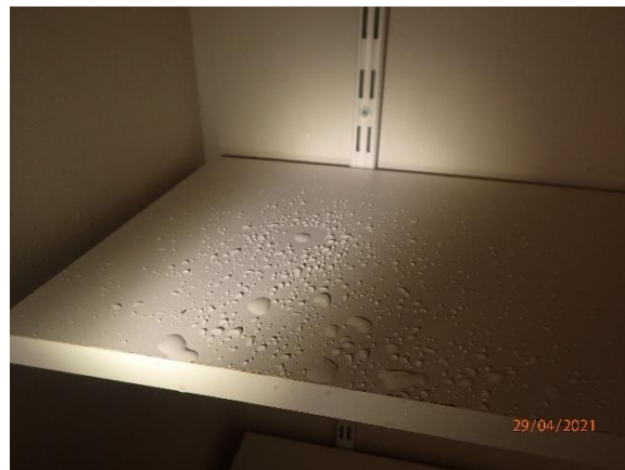
Kuva 31. Rakenneavauksen 1 kohdalla yläpohjan rakenne on vesimärkä, avauskohdan alapuolelle kertyi avauksen jälkeen vesilammikko
