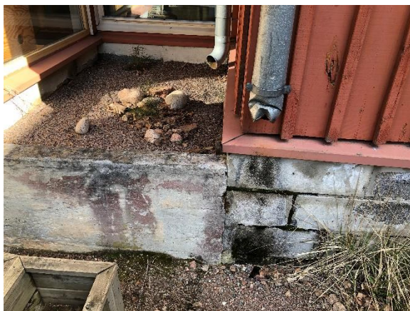
Kuva 38. Sadevesijärjestelmä ohjaa kattovedet liian lähelle rakenteita
