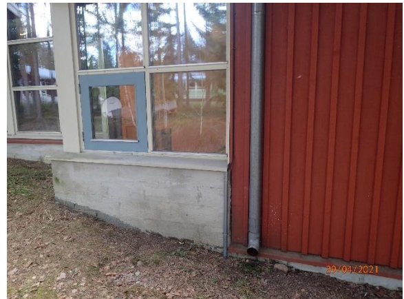
Kuva 5. Kattovedet ohjautuvat rakennuksen vierustalle
