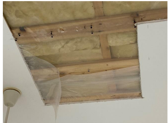
Kuva 27. Rakenneavaus 5, höyrinsulun saumojen liittymät ovat epätiiviyttä
