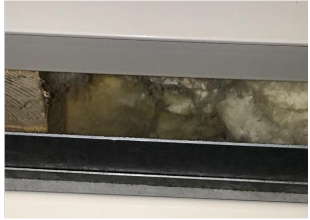
Kuva 47. Avointa ääneneristysvillaa venttiilin sisäpuolella
