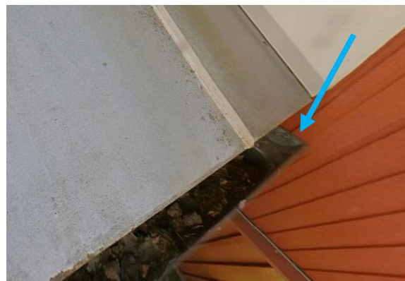
Kuva 39. Roskaisen vesikourun pääty on kiinni ulkoseinässä
