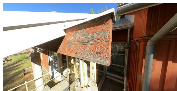
Kuva 41. Katoksen heikkokuntoisia rakenteita
