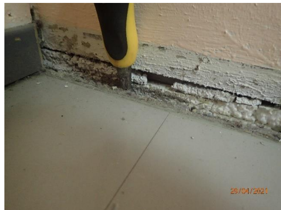
Kuva 9. Epätiivis alapohja-ulkoseinälittyjä itäsiiven luokassa
