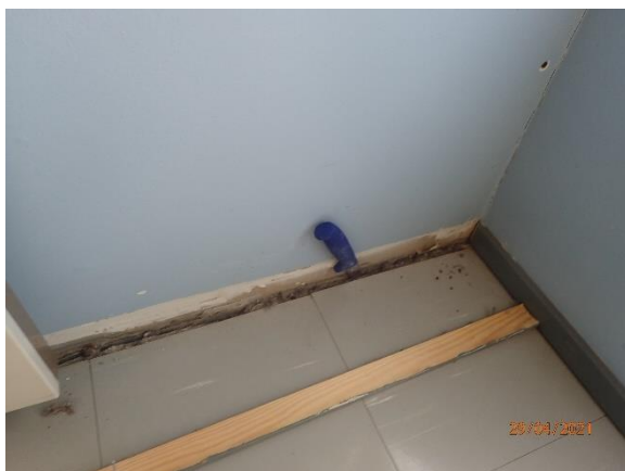
Kuva 10. Epätiivis liittyjä laajennusosan suuressa luokassa
