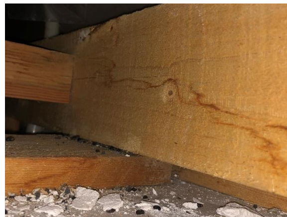
Kuva 33. Kosteusjälkiä aulan alakaton puurakenteissa sekä jyrsijöiden jätöksiä alakattolevyn päällä
