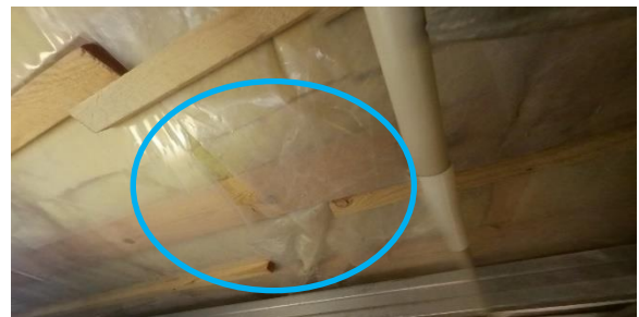
Kuva 29. Käytävän kohdalla höyrinsulkumuovien liittymäkohdassa suuri rako
