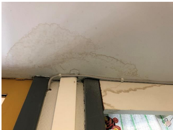
Kuva 32. Kosteusjälkiä aulan katossa
