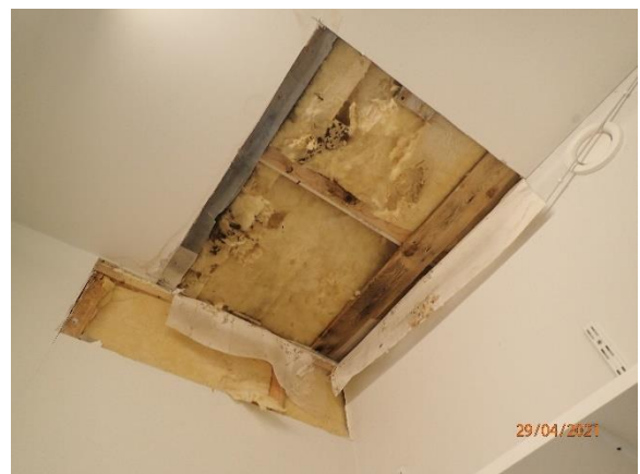
Kuva 45. Jyrsijöiden jätöksiä yläpohjaeristeessä höyrynsulkumuovin päällä
