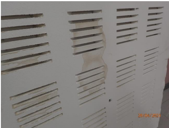
Kuva 26. Luokan alakattolevyn kosteusjälkiä
