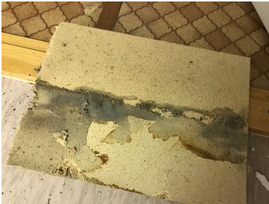
Kuva 28. Pukuhuoneen 117 oviaukon smyygin taustan näkyvää mikrobikasvustoa
