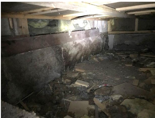
Kuva 22. Rakennusjätettä maapohjan päällä, alapohjassa roikkuva tuulensuojalevy, rakenneavaus 7
