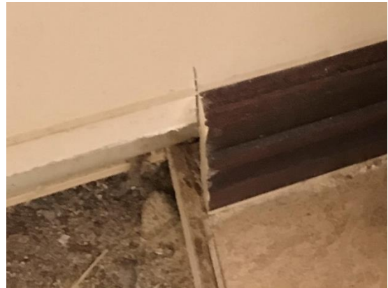
Kuva 29. Alapohjan ja ulkoseinän epätiivis liittyminen
