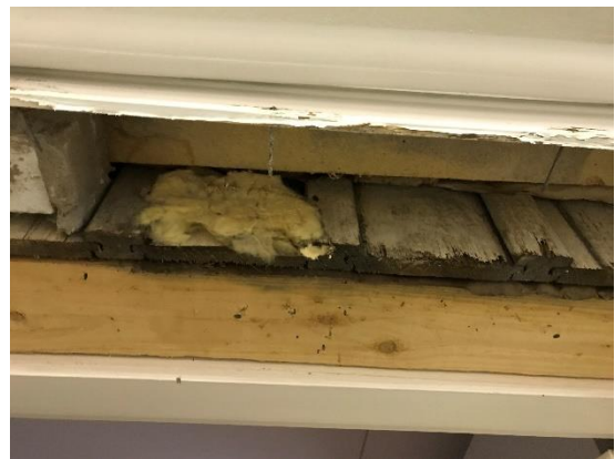
Kuva 27. Vanhan ulkoseinän ja lisäsiiven liittymä on epätiivis
