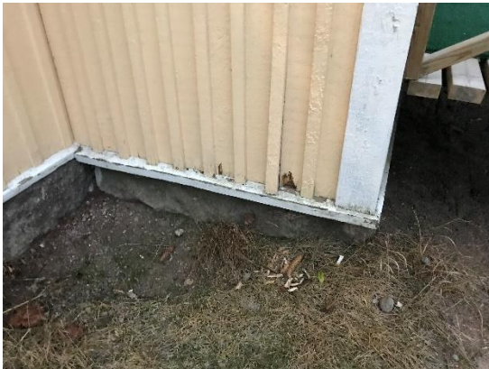
Kuva 20. Lahovaurioitunut ulkovuoraus rakenneavauksen 7 kohdalla
