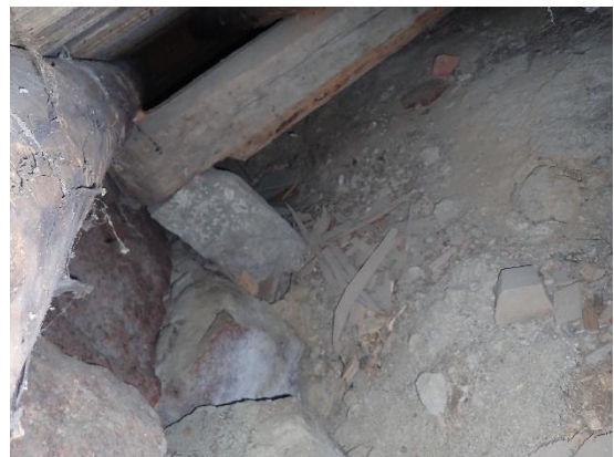
Kuva 19. Tuulettuva rossipohjan maapinnalla puulastuja, rakenneavaus 6
