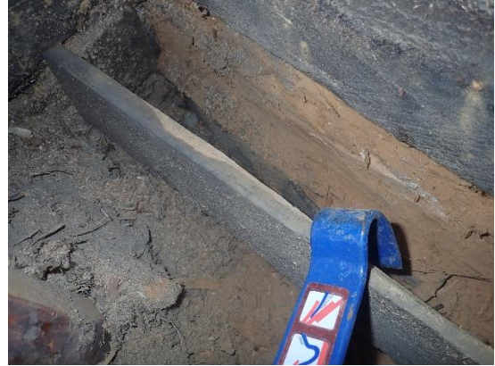
Kuva 5. Lahoja hirttä, rakenneavaus 3
