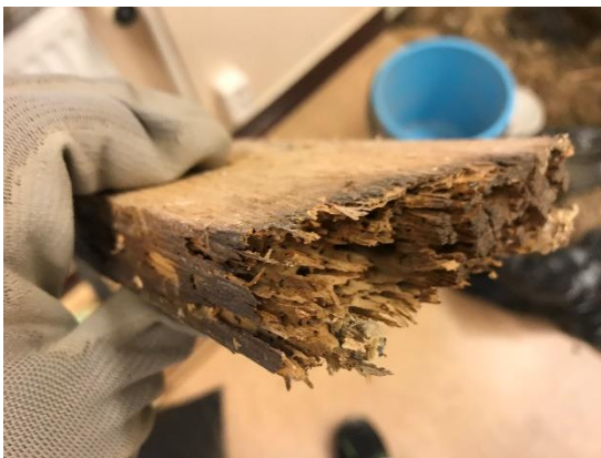
Kuva 18. Alapohjan laudoituksen laho- ja hyönteisvaurioita, rakenneavaus 6
