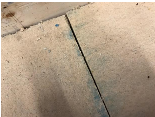
Kuva 14. Alapohjarakenteessa on epätiivelyskohtia, rakenneavaus 5
