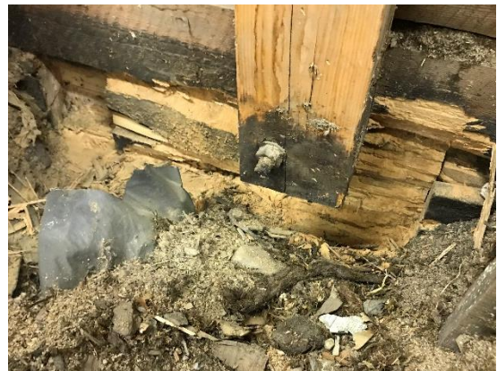
Kuva 9. Kosteuden aiheuttamia laho- ja hyönteisvaurioita alimmissa hirsissä ja lautapaikassa rakenneavauksen 4 kohdalla
