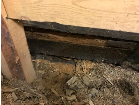
Kuva 4. Laho- ja hyönteisvaurioitunut ulkoseinän hirsi sekä lautapaikka, rakenneavaus 3
