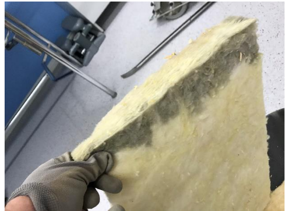
Kuva 13. Alapohjan eristevillassa havaittavia ilmavuotojen aiheuttamia tummentumia, rakenneavaus 5
