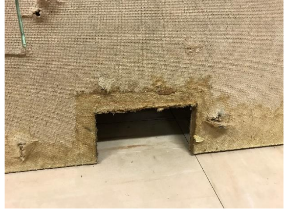
Kuva 11. Siivousvesien aiheuttamia kosteusjälkiä lattian levytyksen alapinnalla, rakenneavaus 4
