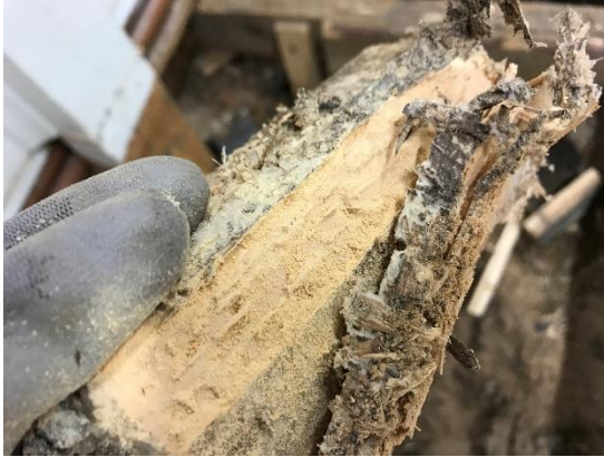
Kuva 10. Mikrobikasvustoa ulkoseinän lautapaikan pinnalla, rakenneavaus 4
