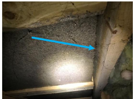
Kuva 23. Epätiivis alapohjaliittymä, rakenneavaus 7
