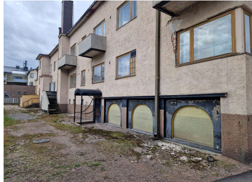
Kuva 27. Eteläjulkisivua. Toisen kerroksen parvekkeet ovat teräsbetonirakenteisia. Etualalla on kellarin uima-allasastomuutoksen yhteydessä tehdyt kaari-ikkunat. Taaempana on uusi ulko-ovi portaineen vuodelta 1991.
