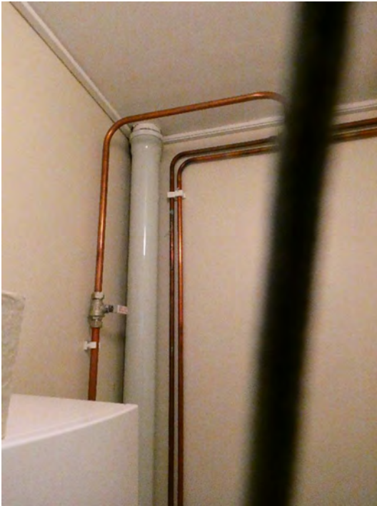
Kuva 31: Yleiskuva teknisestä tilasta.
