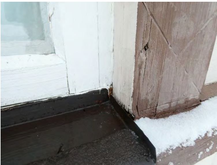
Kuva 20: Vesipellityksen saumaus puuttui.
