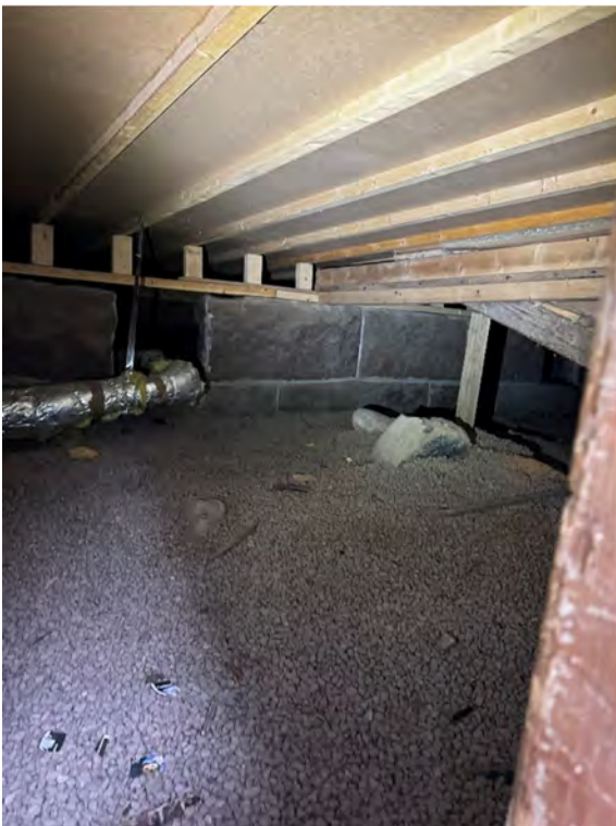
Kuva 10: Alapohjan palkkien tuenta oli painunut.
