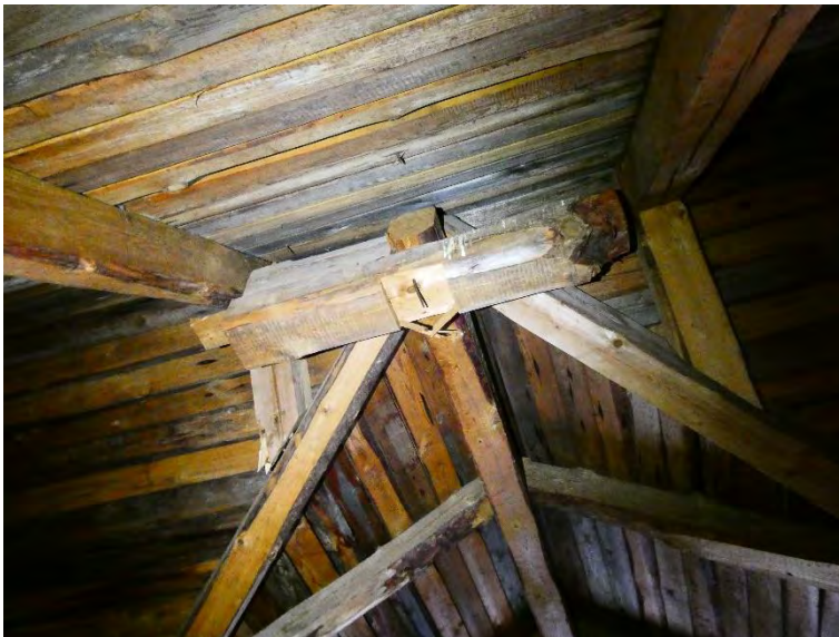
Kuva 29: Pilari oli poistettu.
