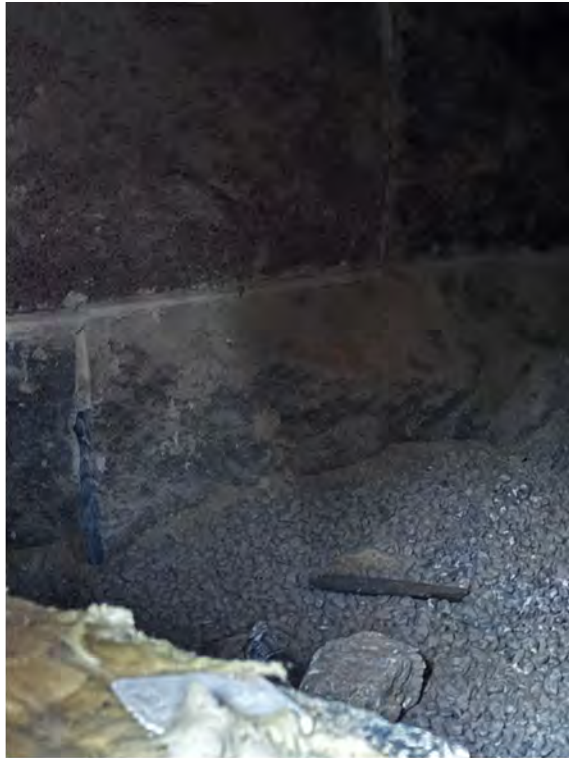
Kuva 9: Ryömintätilan maa-aines oli soraa.
