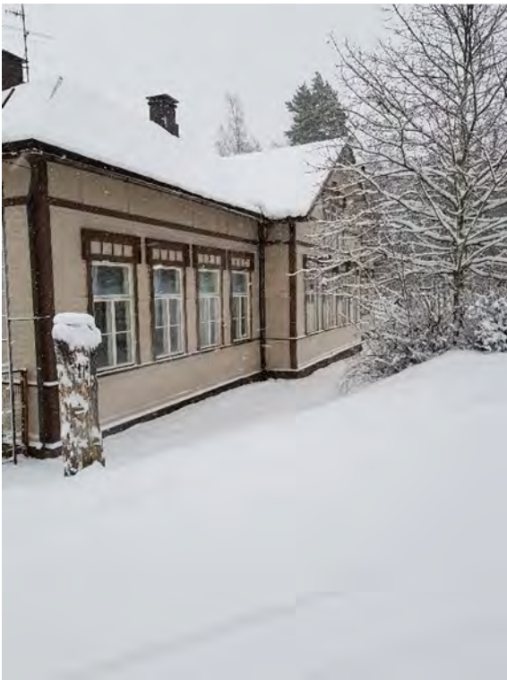
Kuva 3: Maanpinta kallistaa rakennukseen päin.
