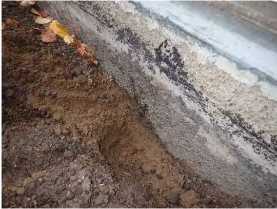
Kuva 1. Perusmuuri ulkopinta, vedeneristys puuttuu, sively irtoaa helposti
