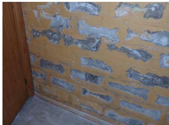
Kuva 4. Kosteusjälkiä perusmuurin verhomuusauksen pinnalla
