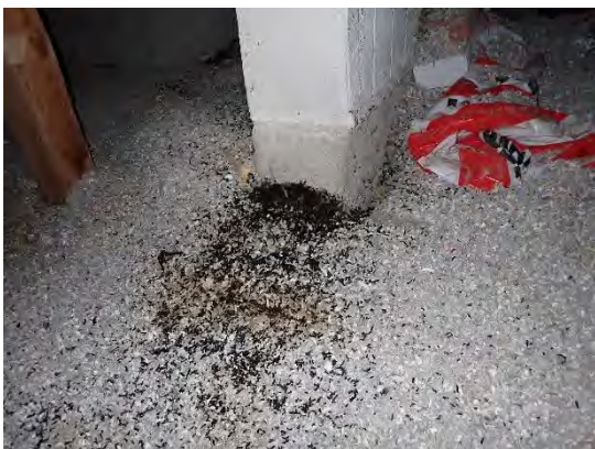
Kuva 35. Vesivuotojälki kulkusillan rikkoutuneen kiinnikkeen alapuolella
