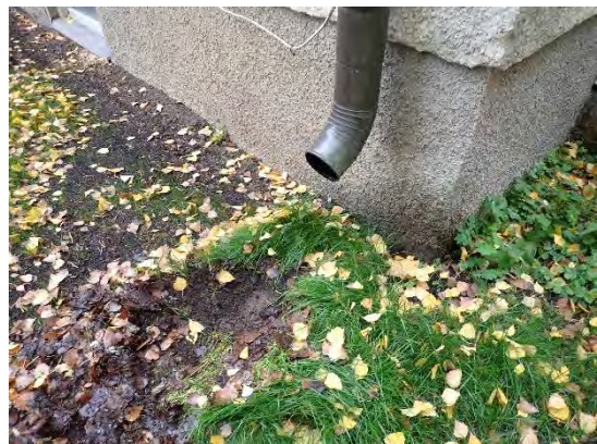
Kuva 44. Kattovedet suoraan rakennuksen vierustalle
