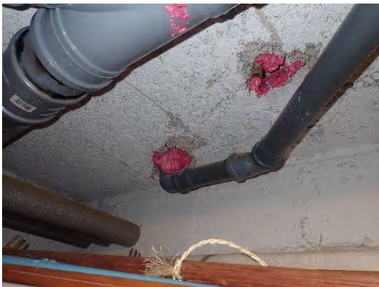
Kuva 25. Välipohjaläpivientejä kellari puolella, tiiveyspuutteita
