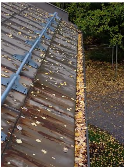
Kuva 43. Lapekouru vaatii puhdistusta
