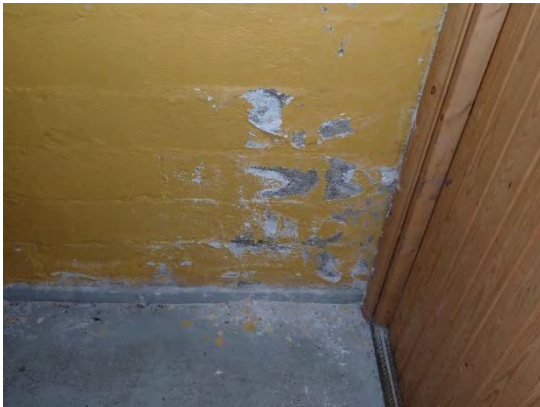
Kuva 3. Kosteusjälkiä kellarin väliseinäpinnalla
