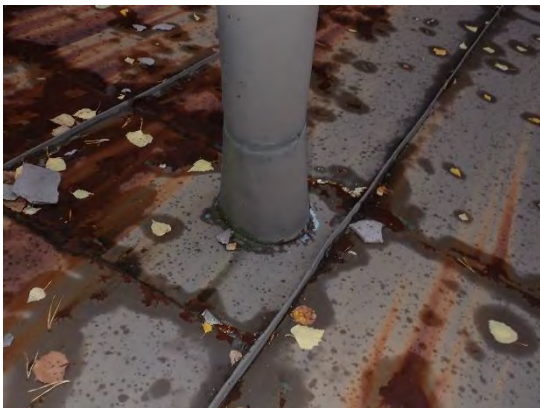
Kuva 29. Viemärin tuuletusputken liittymä vesikatteeseen ei ole tiivis
