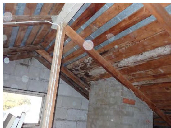
Kuva 34. Piipunjuurivuoto jälkiä YP tilassa
