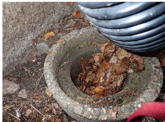
Kuva 46. Betoniputket ovat täynnä eloperäistä ainesta ja hiekkaa.
