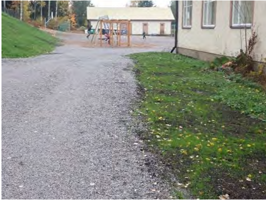
Kuva 39. Ylärinteen puolella maanpinnan muotoilu on puutteellinen ja kasvatuskerros kiinni rakennuksessa
