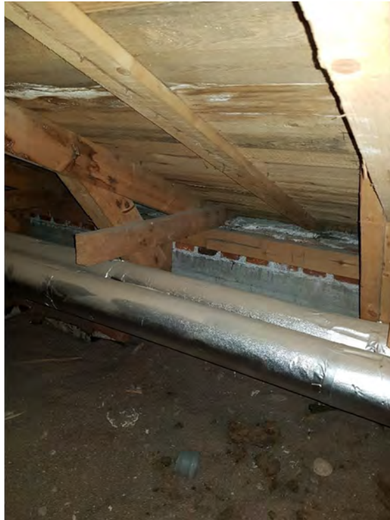
Kuva 38: Räystäällä ei ollut tuuletusta.
