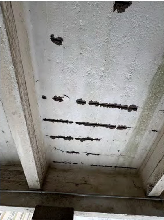
Kuva 22: Sisäpihan sisäänkäynnin katoksen raudoitevaurioita.
