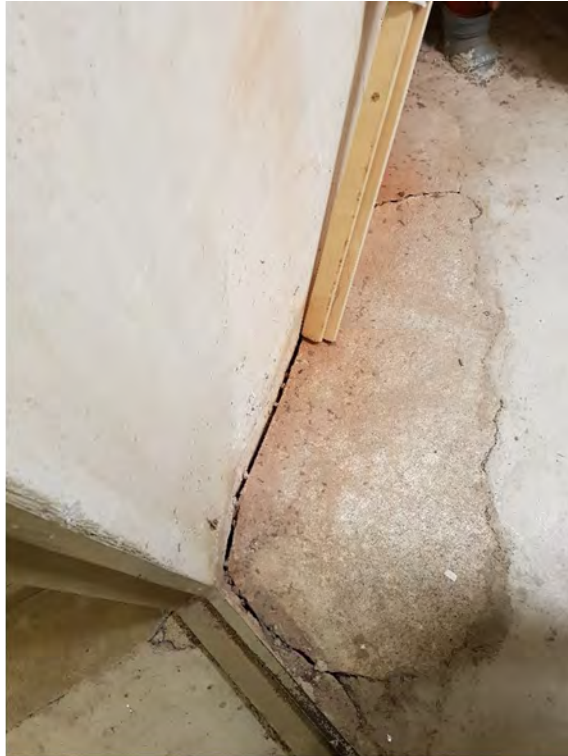
Kuva 9: Alapohjan liitoksissa ja lattioissa oli halkeamia.
