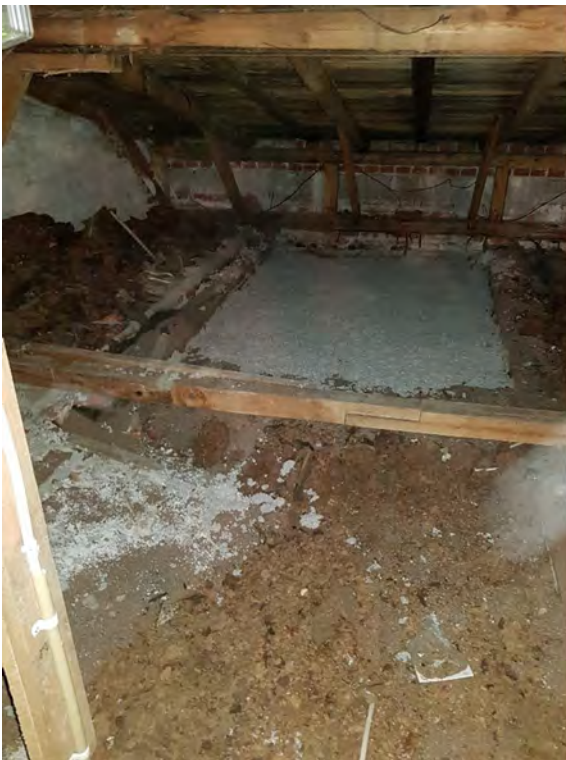
Kuva 39: Vesikatto oli osittain korjattu
