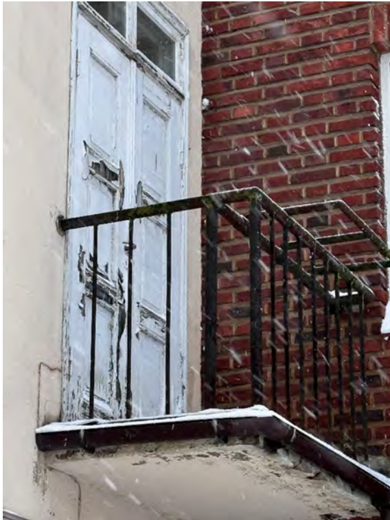
Kuva 27: Parvekkeen oven vaurioita.
