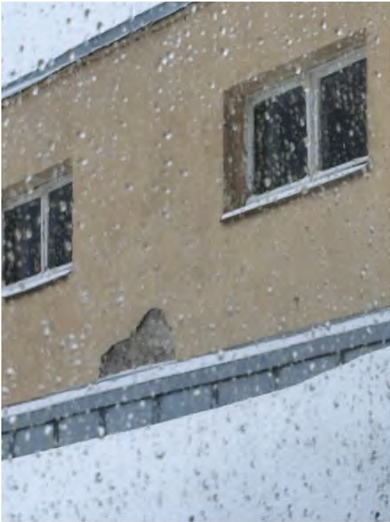
Kuva 20: Julkisivurappauksissa havaittiin puutteita.
