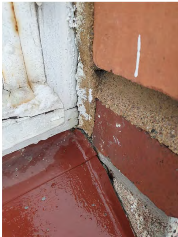
Kuva 32: Vesipeltien tiivistykset olivat puutteellisia.
