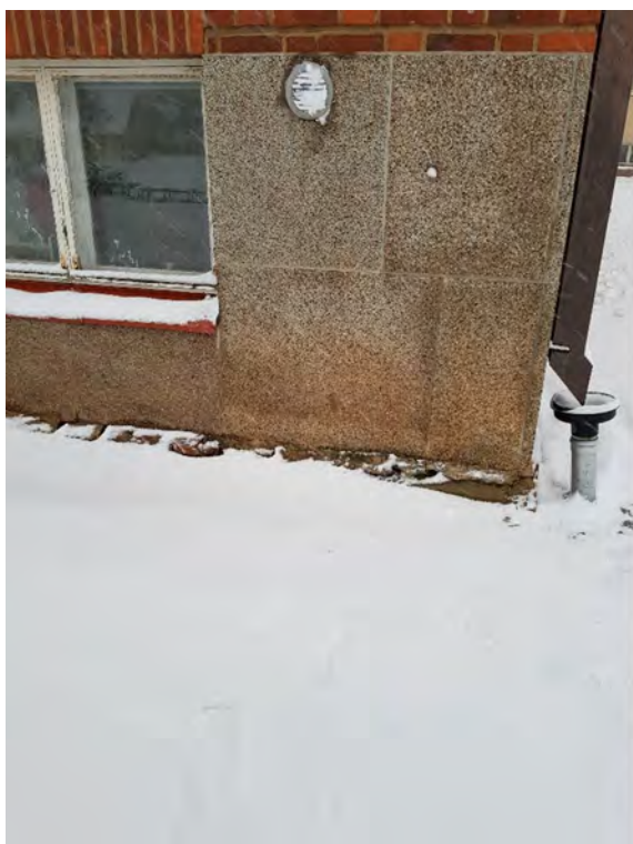
Kuva 4: Patolevyä tai listaa ei havaittu.
