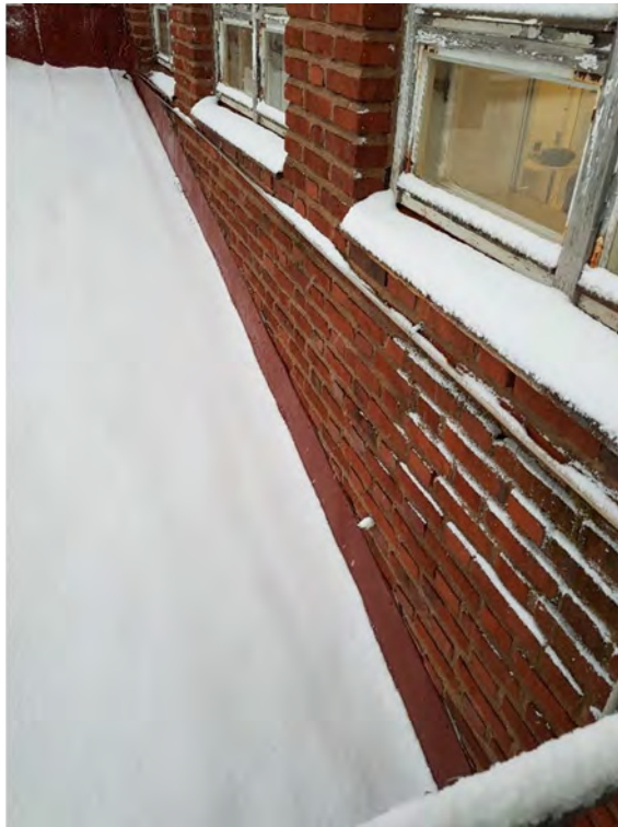
Kuva 36: Vesipellin saumaus julkisivuun oli puutteellinen.
