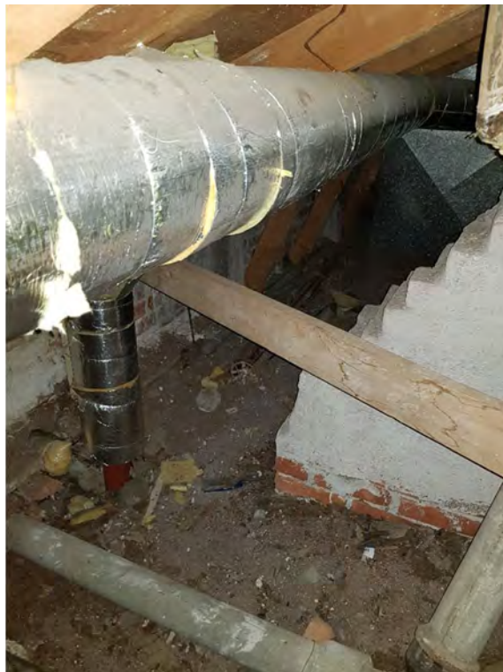
Kuva 40: Ullakkotilassa oli paljon pieneläinjätöksiä.
