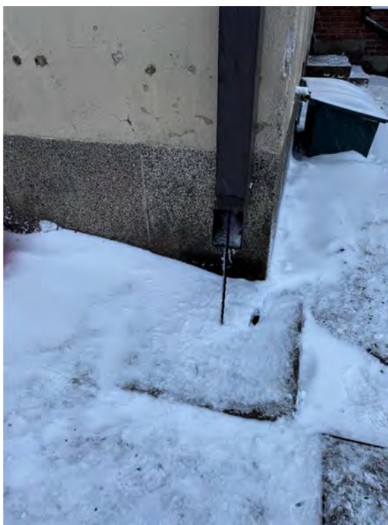
Kuva 5: Kattovedet oli johdettu sadevesikaivoon.
