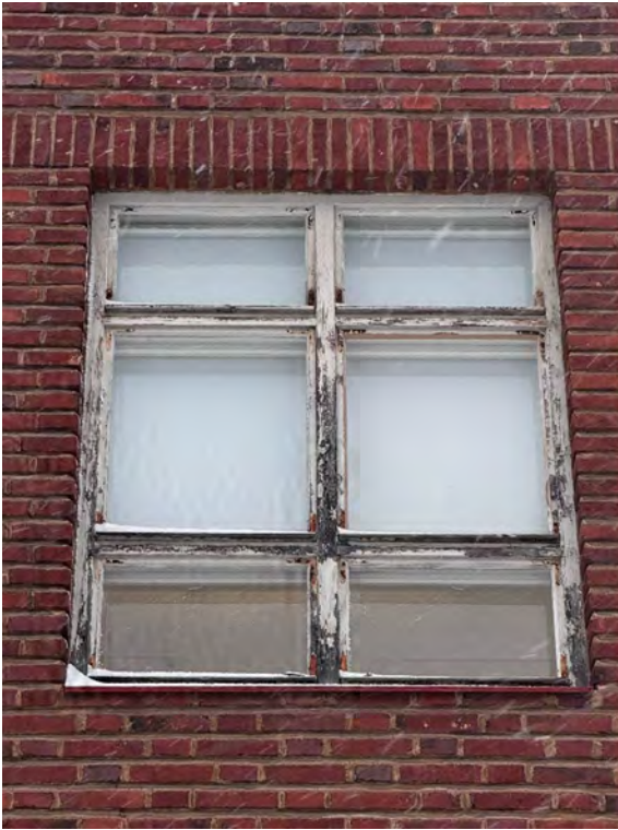
Kuva 29: Ikkunakarmit olivat välttävässä kunnossa.
