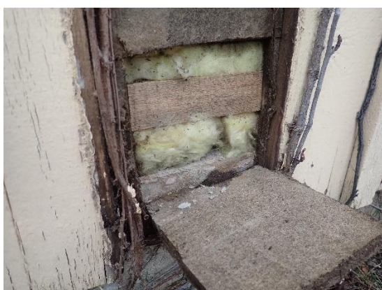
Lisäsiiven ulkoseinä, näyte mMKB2 eristeen ulkopinnasta (vanha viite vauriosta)
