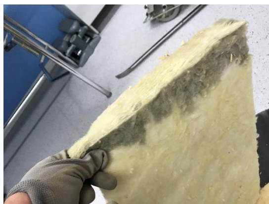
Ilmavuotojen aiheuttamia tummentumia näytteen mMKB1 ottokohdassa (heikko viite vauriosta)
