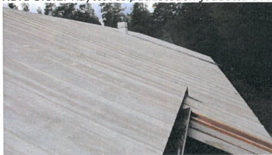
Kuva 3.8.3. Vesikatolla on huippuimuri.
