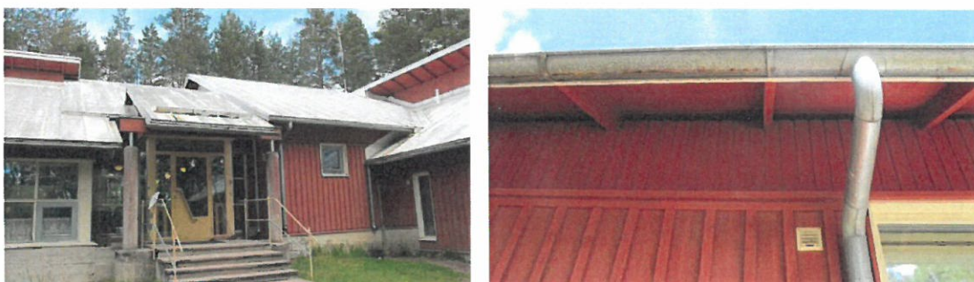
Kuva 2.11.8 Vesikatto on kauttaaltaan heikossa kunnossa. Kuva 2.11.9 Rännit ovat täynnä likaa ja ruostuneet.
