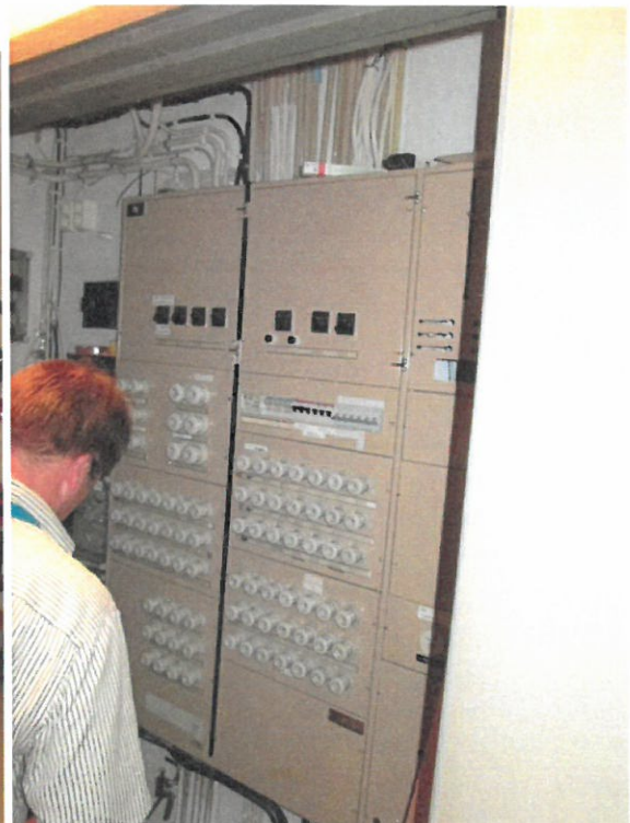
Kuva 4.11.4. Sähköpääkeskus on TN-S-järjestelmällä toteutettu.
