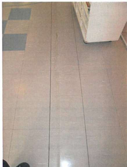
Kuva 2.11.3 Aulan lattiassa on koko käytävän halkaiseva painuma jälki.
