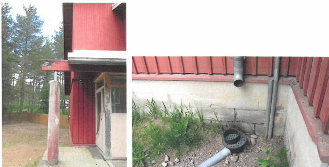
Kuva 2.11.10 Katosten puupalkit ovat lahonneita. Kuva 2.11.11 Sokkeli on kulunut syöksytorvien kohdissa.
