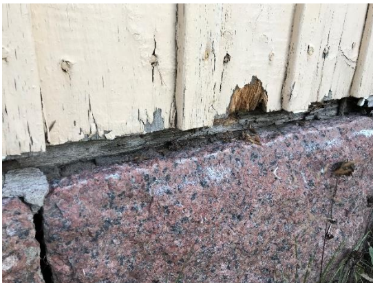
Kuva 10. Lahovaurioitunut ulkovuoraus ja tippalista
