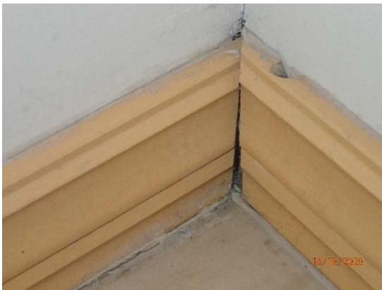
Kuva 2. Epätiivis liittymä Luokkahuoneen 101 opettajan työpöydän läheisyydessä
