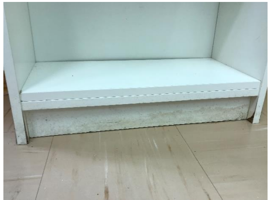
Kuva 15. Kosteusvaurioitunut hyllyn alaosa, luokkahuone 101
