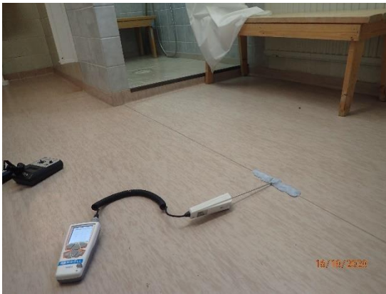
Kuva 14. Suhteellinen kosteuspitoisuus Pukuhuoneen 118 muovimattopinnoitteen alla oli poikkeuksellisen suuri
