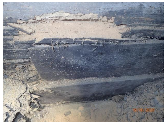
Kuva 9. Kosteuden aiheuttamia laho- ja hyönteisvaurioita alimmissa hirsissä rakenneavauksen 2 kohdalla
