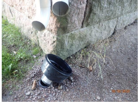
Kuva 13. Irrallinen rännikaivo ei poista kattovesiä rakennuksen vierustalta
