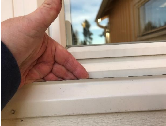
Kuva 12. Väärin asennettu ikkunan tippapelti
