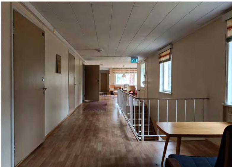
Kuva 47. Toisen kerroksen aula. Poistumiskyttin kohdalla oleva ulkoseinä on kertaalleen avattu kosteusongelmien takia.
