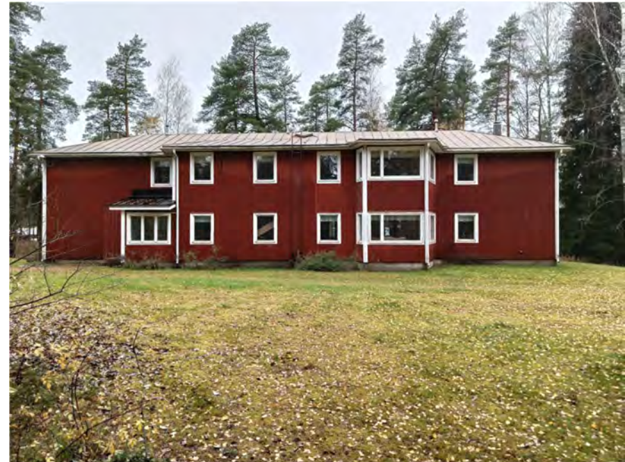
Kuva 45. Tyttöjen majoitustalon sisääntulojulkisivu. Toisen kerroksen erkkerin vasemmalla puolella ikkuna on uusittu ja seinää korjattu vesivahingon johdosta.
