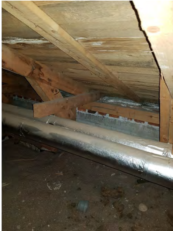
Kuva 38: Räystäällä ei ollut tuuletusta.
