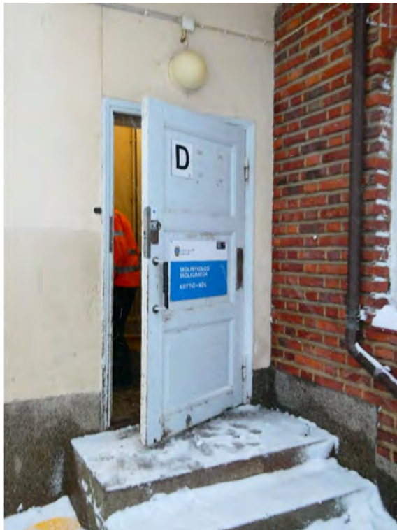
Kuva 26: Yleisten tilojen ulko-ovissa oli maalivaurioita.
