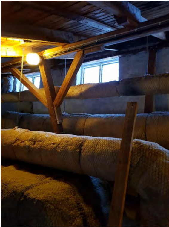
Kuvat 41: Putkien eristeissä on oletetusti asbestia
