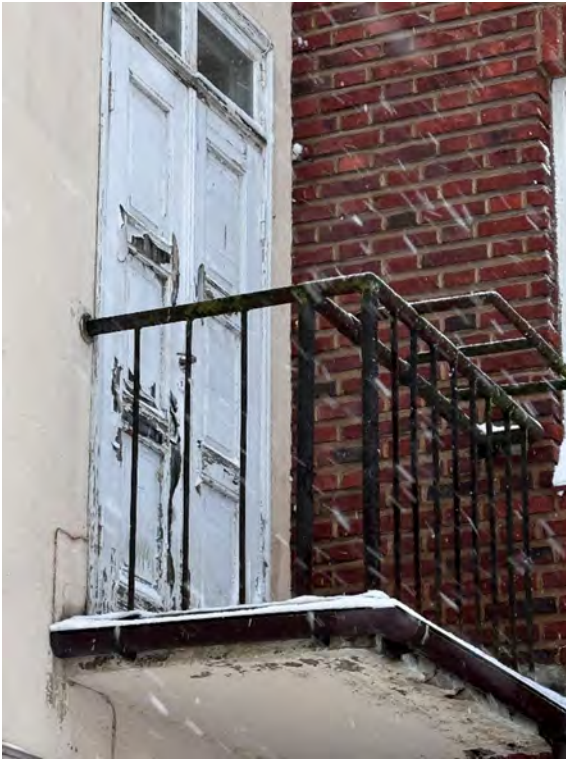
Kuva 27: Parvekkeen oven vaurioita.
