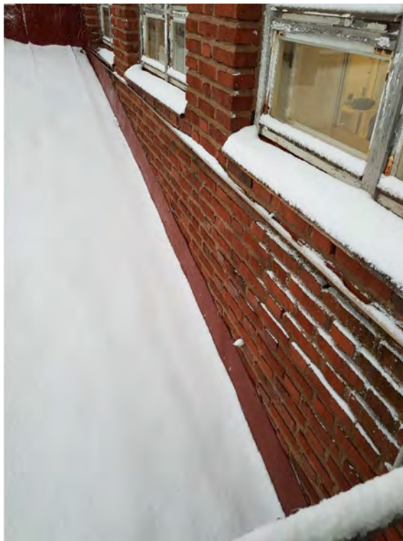
Kuva 36: Vesipellin saumaus julkisivuun oli puutteellinen.
