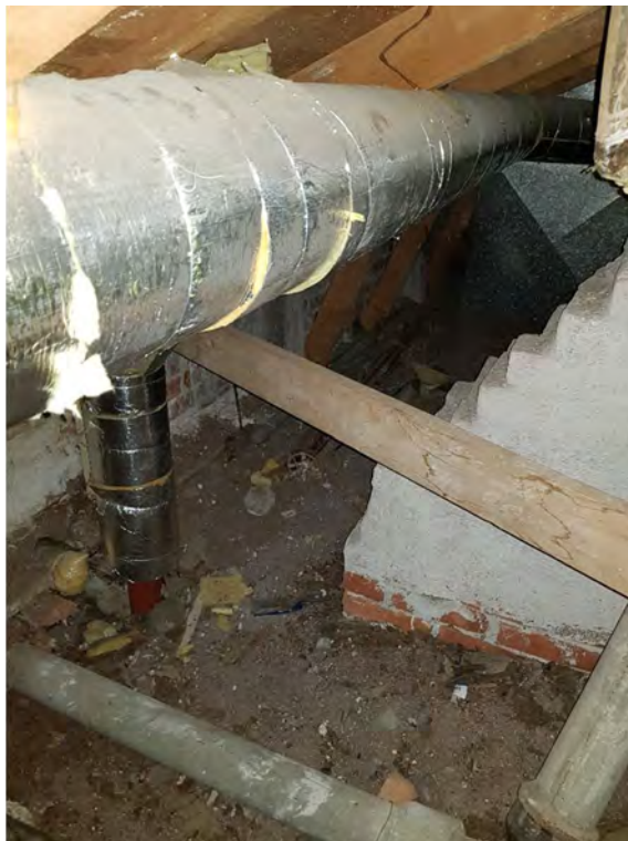
Kuva 40: Ullakkotilassa oli paljon pieneläinjätöksiä.
