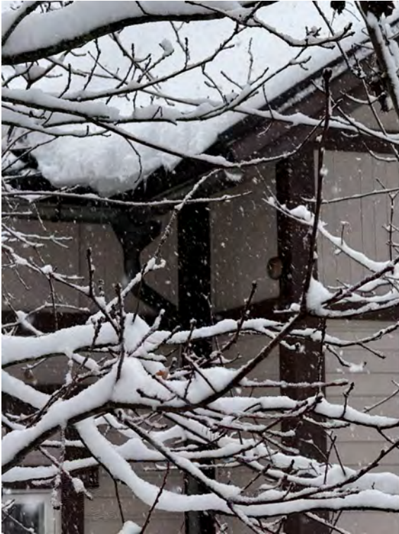
Kuva 6: Räystäskouruissa oli puutteita.
