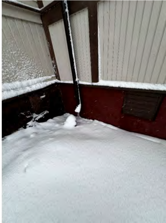
Kuva 7: Rännikaivo kokonaan irti syöksyputken alla.
