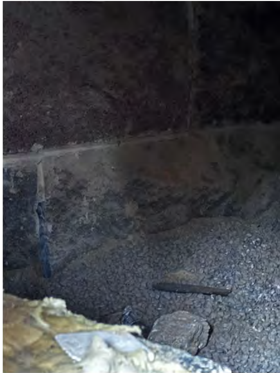
Kuva 9: Ryömintätilan maa-aines oli soraa.
