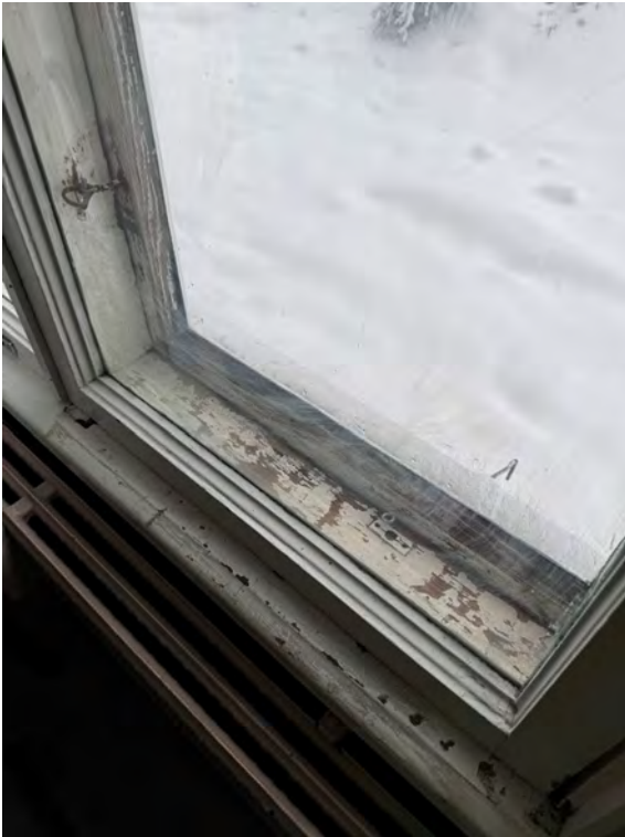
Kuva 19: Ikkunakarmien vaurioitunutta maalipintaa.
