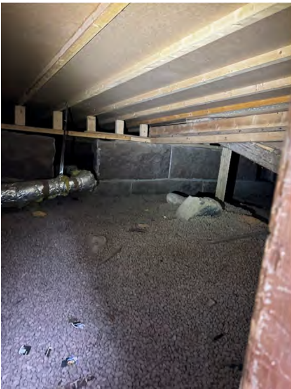
Kuva 10: Alapohjan palkkien tuenta oli painunut.
