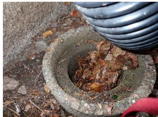
Kuva 46. Betoniputket ovat täynnä eloperäistä ainesta ja hiekkaa.
