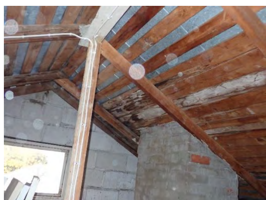
Kuva 34. Piipunjuurivuoto jälkiä YP tilassa
