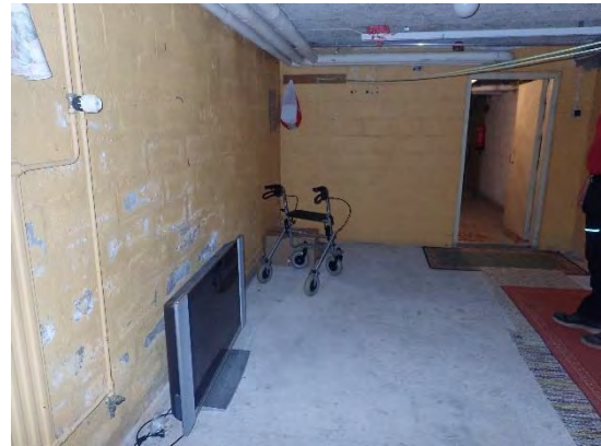
Kuva 10. Pinnoittamaton kellarin alapoha
