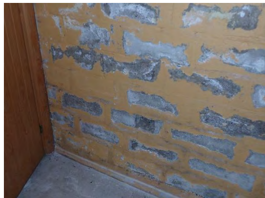
Kuva 4. Kosteusjälkiä perusmuurin verhomuusausten pinnalla
