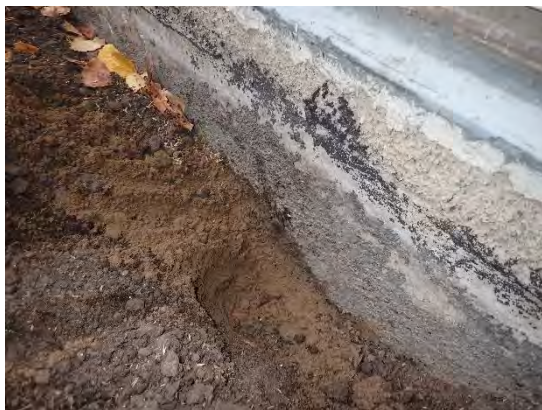
Kuva 1. Perusmuuri ulkopinta, vedeneristys puuttuu, sively irtoa helposti
