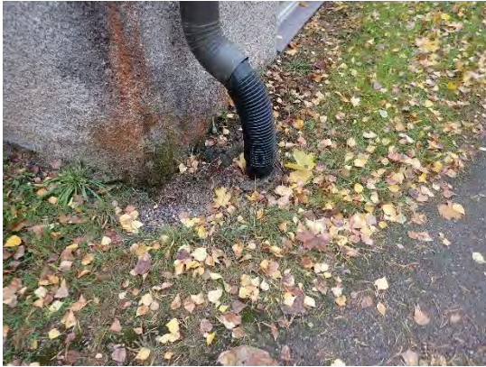
Kuva 45. Koulun tilojen puoleisella osalla sadevedet katolta betoniputkeen
