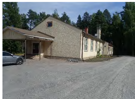
Kuva 42. Liikennealue ylärinteen puolella, pintavedet virtaavat rakennusta vasten.
