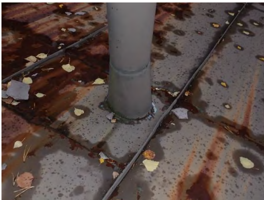
Kuva 29. Viemärin tuuletusputken liittymä vesikatteeseen ei ole tiivis
