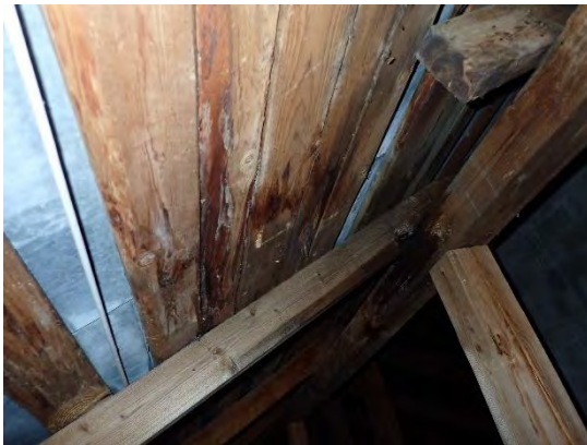
Kuva 37. Vuotojälki harjan läheisyydessä
