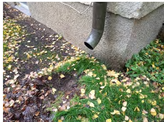
Kuva 44. Kattovedet suoraan rakennuksen vierustalle
