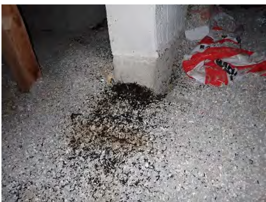
Kuva 35. Vesivuotojälki kulkusillan rikkoutuneen kiinnikkeen alapuolella
